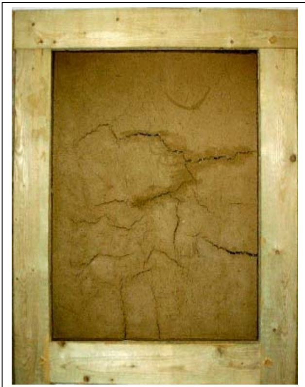
Bild 3: Lehmschwindrisse eines Fachwerkfeldes
